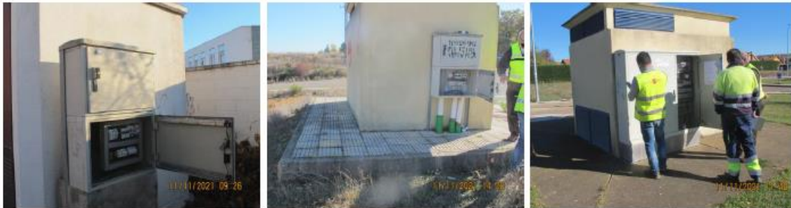
Algunos cuadros en mal estado, con espacio insuficiente, adosados al CTS y apoyados en la acera perimetral del mismo.
