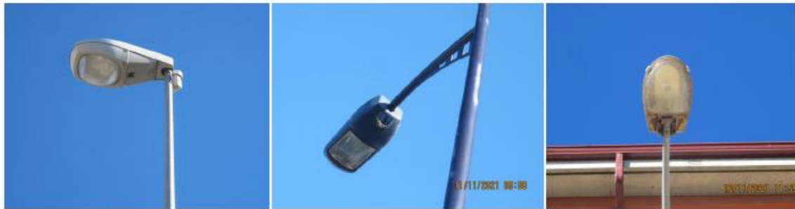
Principales tipos de luminarias viarias instalados actualmente, de VSAP, a sustituir por LED.
